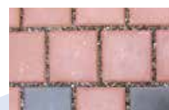
Drainfugenpflaster [Bild: LRA WT]
